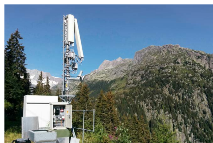
Projekt Antenna- und System Upgrade Swisscom
