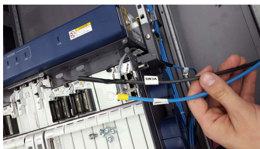
Stromerschliessung für Huawei Equipment
